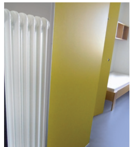
BEMM Mera, 2-Säuler 1800x270mm, 6 Elemente, Anschluss unten gleichseitig DN 15 (1/2")x 50mm, JVA Bremervörde, Einbausituation in den Hafräumen, vandalensicher durch Spezialbefestigungen.
