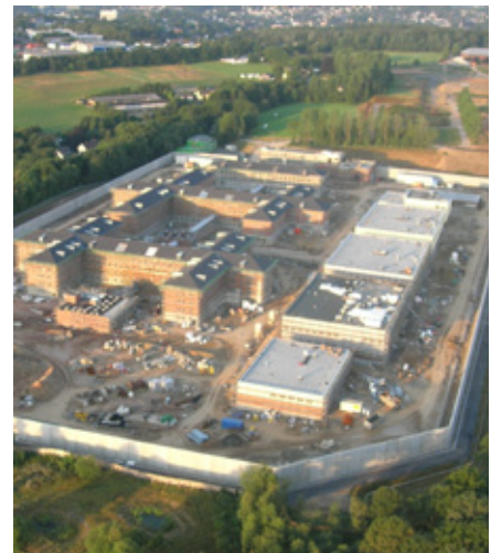
Großobjekt JVA Wuppertal, ausgestattet mit BEMM Mera und Vera, alle mit Spezialbefestigungen, vandalensicher gemäß der Anforderungsklasse 4 VDI 6036 und teils galvanisch verzinkt für die Feuchträume.
